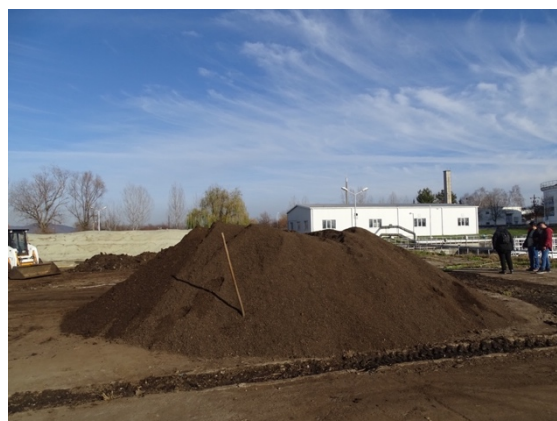
FOTO: INSTALAȚIA DE COMPOSTARE A NĂMOLURILOR PROVENITE DE LA STAȚIILE DE EPURARE A APELOR UZATE MIOVENI, ARHIVA APPFE
